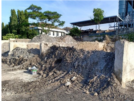
Gambar 2. Tempat Penampungan Sludge
