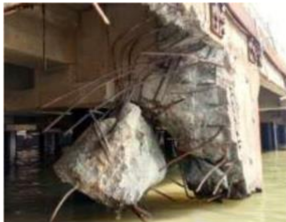
Gambar 3. Kerusakan Struktur Bangunan pada Dermaga di Gresik
