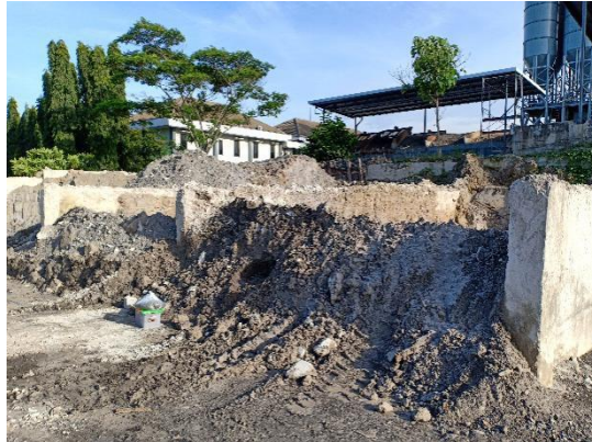
Gambar 2. Tempat Penampungan Sludge
