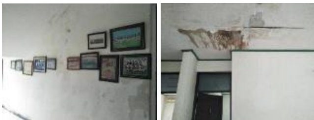
Gambar 1. 1. Dinding dan plafon wisma Persebaya yang rusak akibat rembesan air hujan Sumber: dokumentasi pribadi
