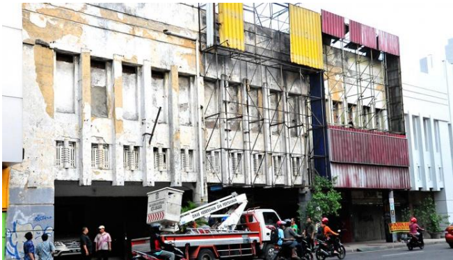
Gambar 1. 1. Restorasi yang terjadi beberapa bangunan Sumber: google.com
