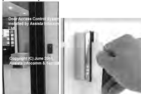
Gambar 19. Keamanan Pintu Menggunakan Sistem Swipe Card
