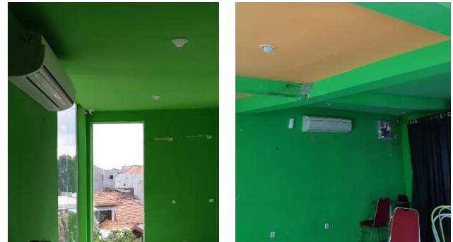
Gambar 14. Penggunaan AC dan sirkulasi udara pada lantai 4
