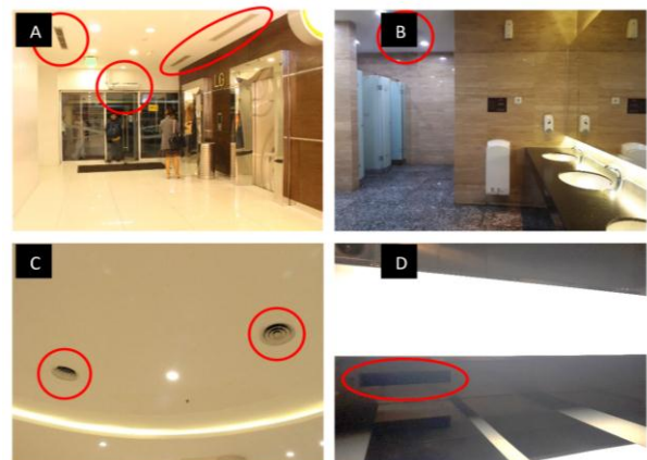
Gambar 9. Fasilitas pendingin pada area pintu masuk (A), toilet (B), area mall (C), dan di dalam lif (D).
