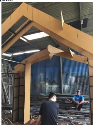
Gambar 4.29. Booth Pada Percobaan Pertama, Mengalami Kegagalan Dalam Pemasangan Atap
