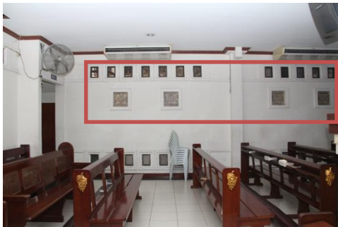
Gambar 4. Celah melalui Ventilasi Kecil pada Dinding
