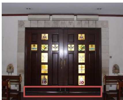
Gambar 6. Celah pada Pintu Akibat Muai Susut Kayu
