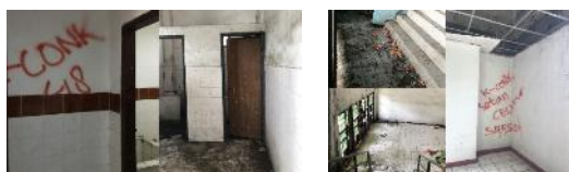
Gambar 1. 2. Kerusakan pada bangunan Sumber: Dokumentasi Pribadi
